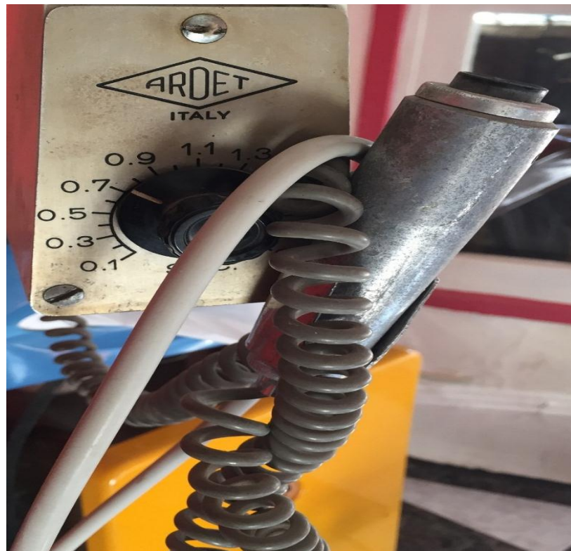
Figure 33 : Branchement anarchique des cables électriques.
