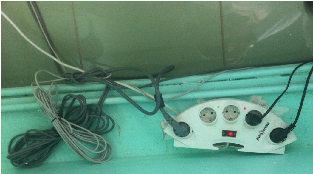
Figure 32 :Branchement électrique non conforme d'un DR.
